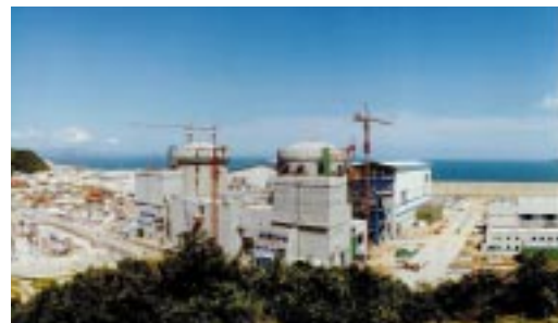
5月に1号機が運開、9月に2号機が送電開始した広東嶺澳原子力発電所
